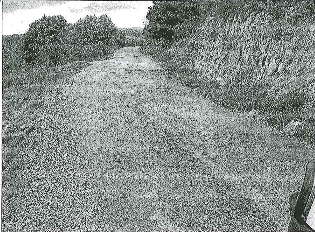
L'estat de la carretera d'Ortedó a Vilanova de Banat és molt deficient.
