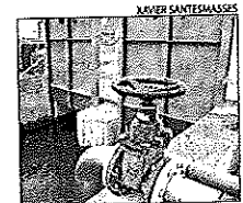
La depuradora de Ratera.
