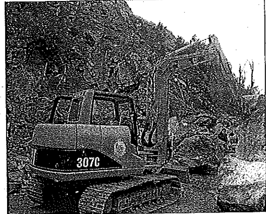
Una grua va retirar les roques que obstaculitzaven la calçada.
