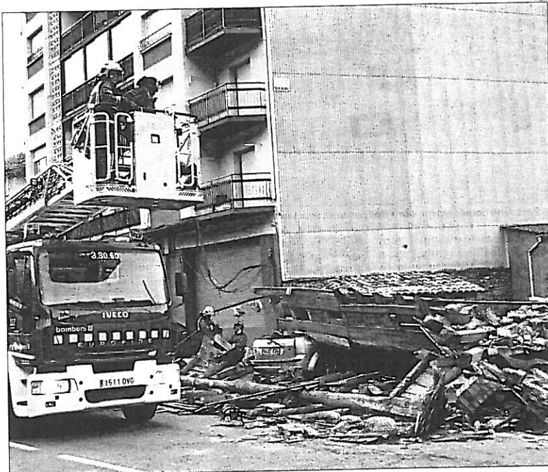
Els Bombers van treballar per retirar la runa que va caure sobre la carretera C-13 al seu pas per Sort.
