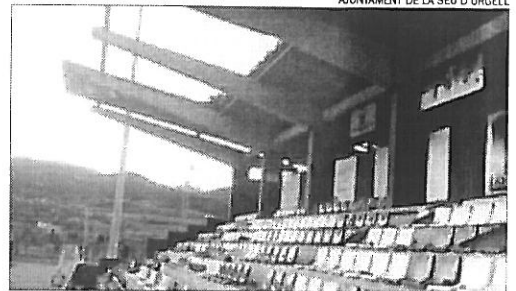
El vent va malmetre la coberta de la graderia del camp de futbol.
