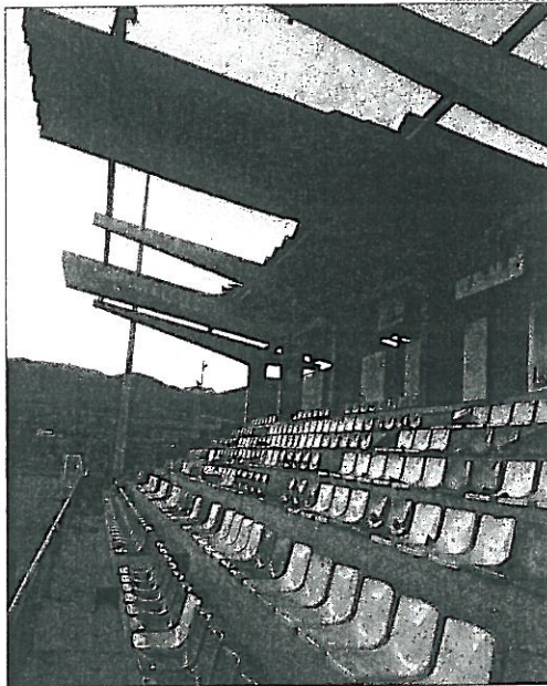
Així va quedar la coberta de la tribuna del camp de futbol de la Seu.
