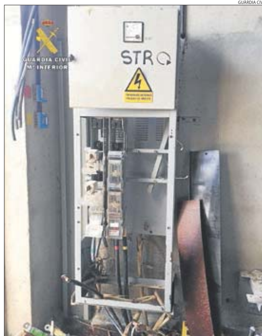
Imatge del transformador elèctric manipulats.
