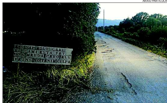
El rètol que han instal·lat els veïns per queixar-se de l'estat del camí
