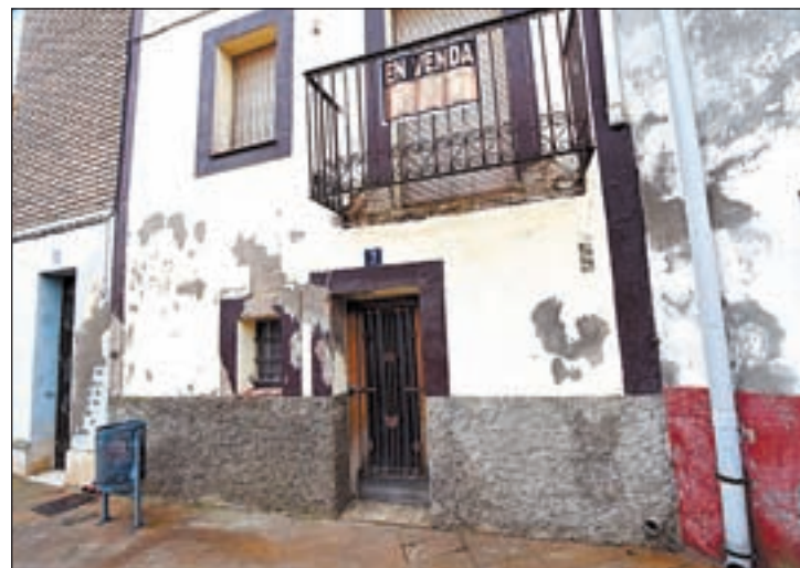
FOTO: Núria García / Estat en el que va quedar el balcó
