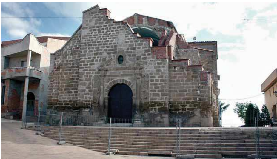
Estat actual del temple, que es va esfondrar el 29 de gener d'aquest any, després de detectar-s'hi greus esquerdes ■ S.I.
