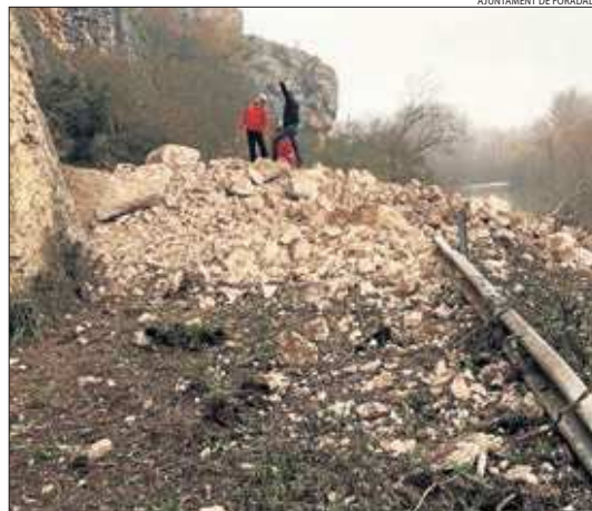
Les roques van envair la calçada i van trencar la tanca de seguretat.
