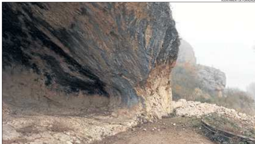
El despeniment de roques a Foradada va tallar completament el principal accés a Salgar.
