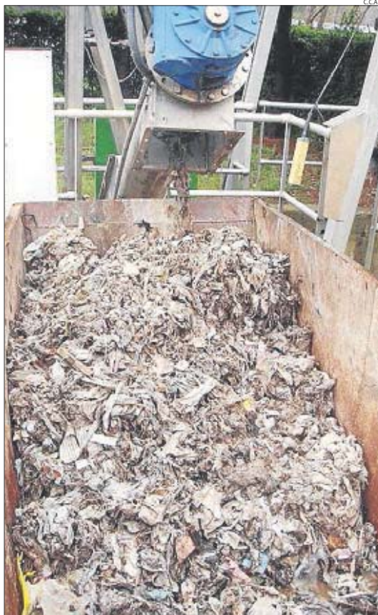
Les tovallolletes que s'acumulen a la depuradora de Montferrer.
