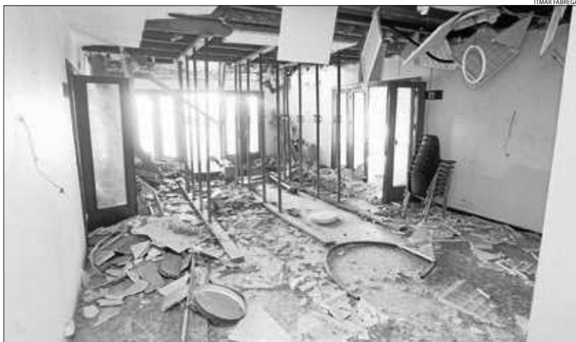
Una de les plantes de l'hotel apuntalada, cosa que demostra el mal estat de l'edifici.
