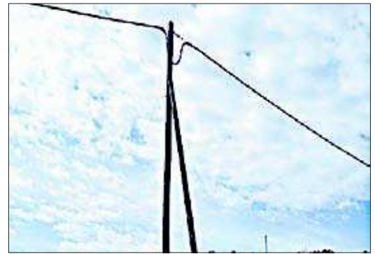
FOTO: Endesa / Imatge de la nova línia elèctrica de baixa tensió
