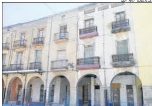
Imatge de les tres façanes en mal estat de la plaça de la Vila.
