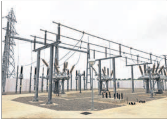
La subestació de Tàrrega s'ha posat en marxa aquest mes.
