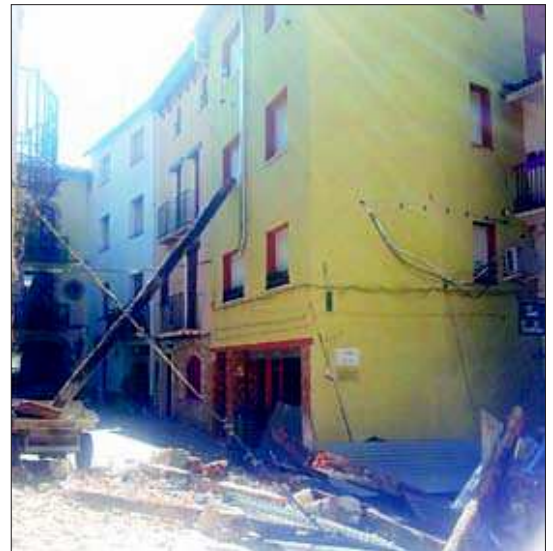
FOTO: Aj.Peramola / Una de les bigues es va empotrar en un edifici
