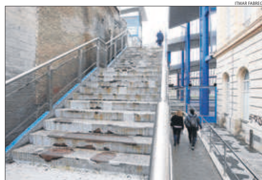
L'estat actual dels esglaons d'accés a la passarel·la.
