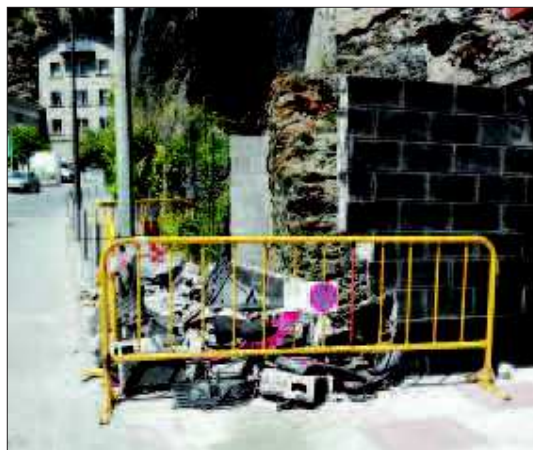
Estat en què va quedar la zona de l'accident.
