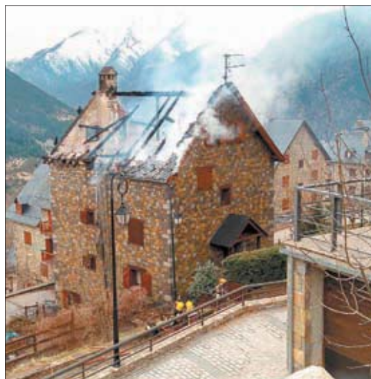
FOTO: / El sostre de l'edifici afectat es va ensorrar degut al foc
