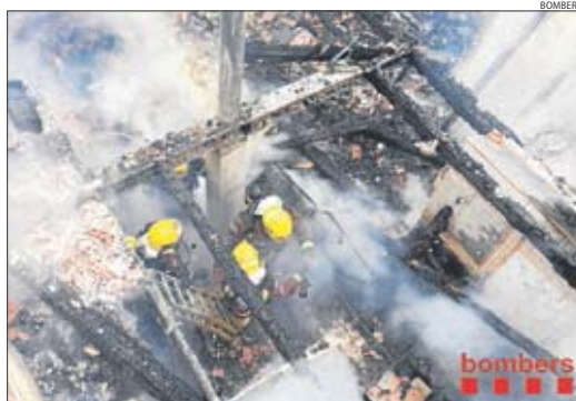
L'àtic va quedar completament calcinat.
