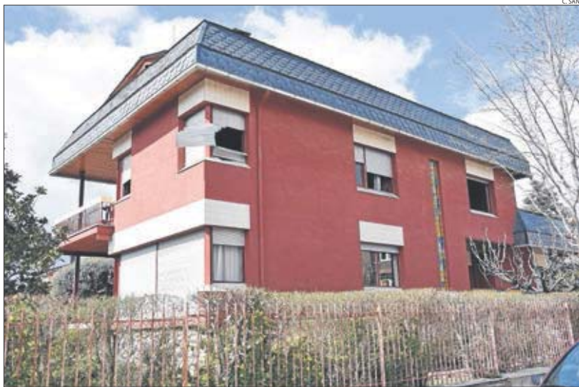
L'incendi va afectar l'habitació del primer pis d'aquest habitatge de la Seu d'Urgell.
