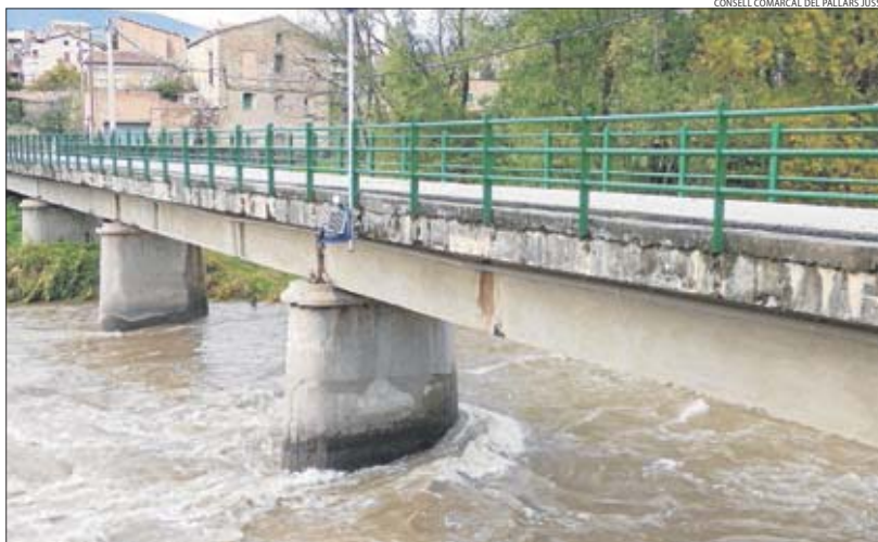
Imatge d'un dels sensors instal·lats a la comarca del Pallars Jussà.
