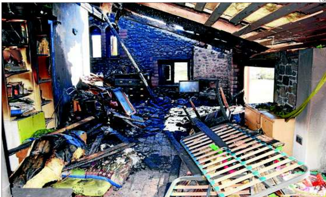
Imatge del menjador de l'habitatge després del foc que el va arrasar ahir a Ribera d'Urgellet.
