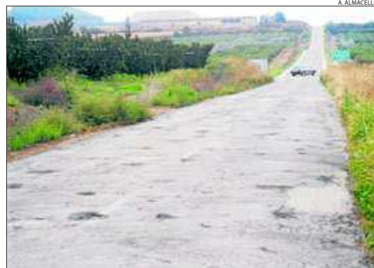
Deteriorament del tram aragonès de la carretera, al fons el català.
