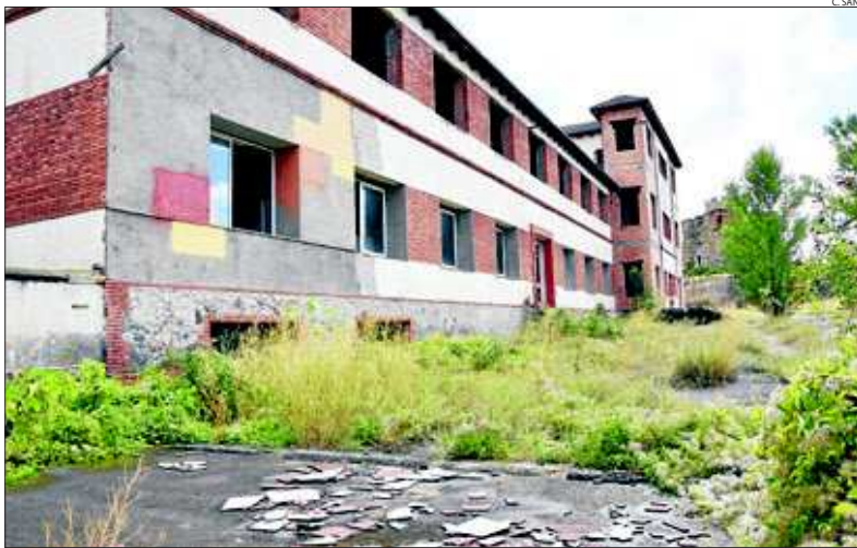
Part de les instal·lacions de la Ciutadella de Castellciutat pertanyen a l'empresa Cevasa.
