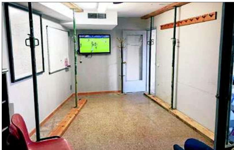
El parc de Seròs es va apuntalar fa uns mesos a causa de deficiències estructurals.
