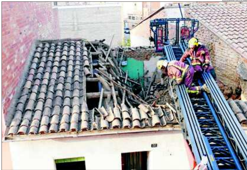
Dos bombers treballen després de l'esfondrament de la teulada de la casa.
