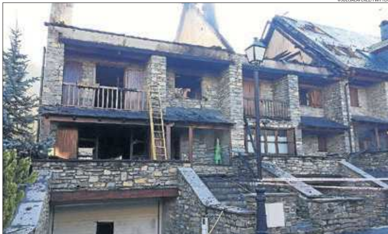
Imatge d'ahir en què es poden veure les destrosses causades en dos dels habitatges.
