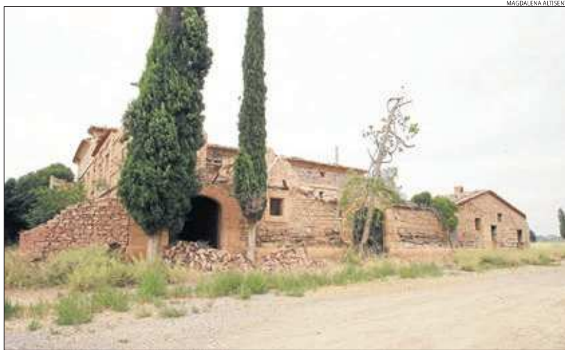
El desprendiment a la teulada i les esquerdes s'aprecien en l'estructura de la casa.
