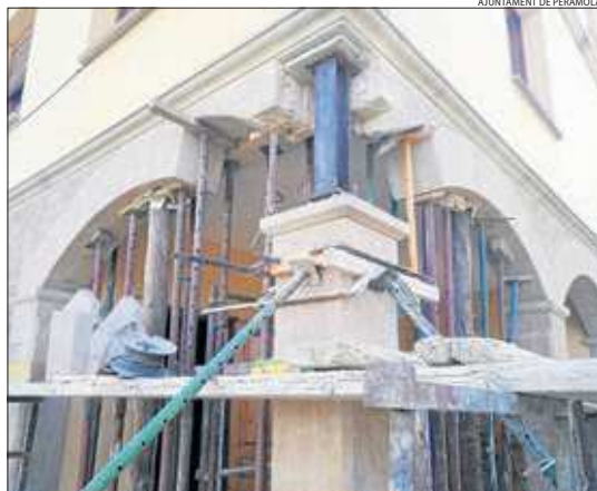
Durant l'obra s'ha reforçat el pilar amb estructures de ferro.
