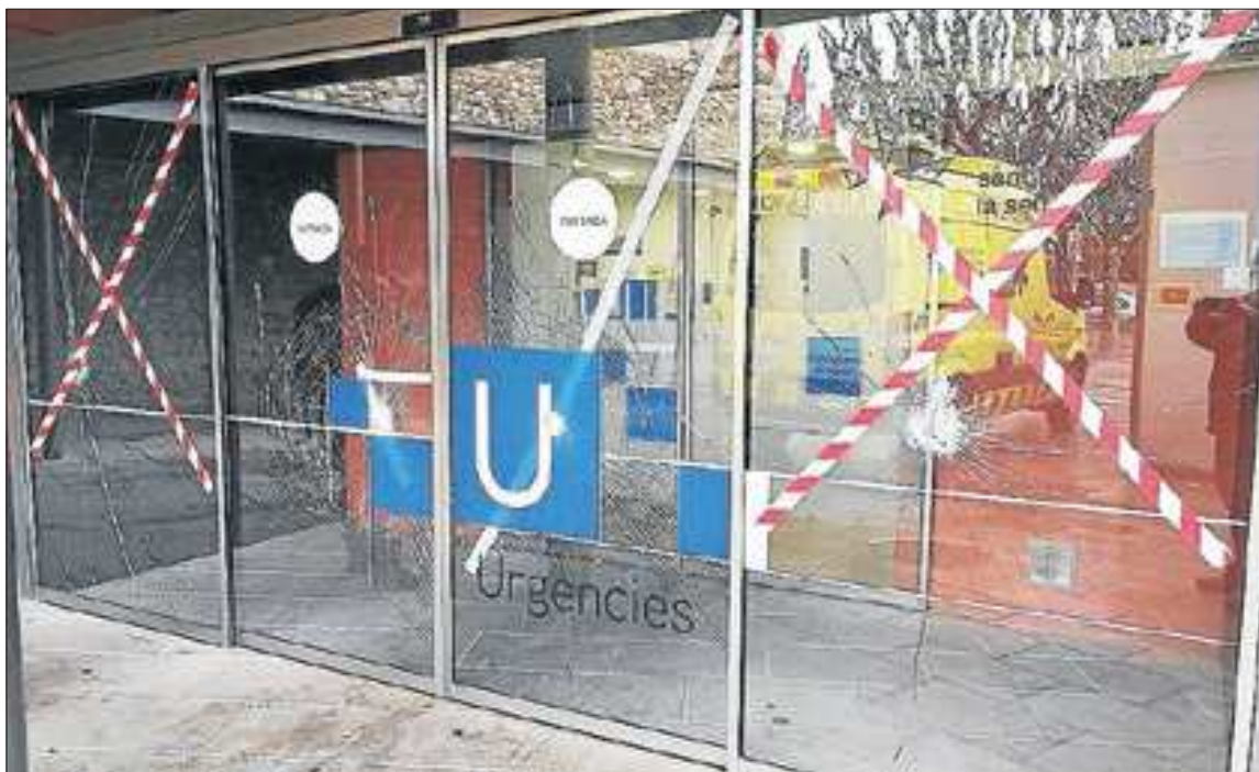
Imatge dels vidres trencats de la porta de l'hospital.
