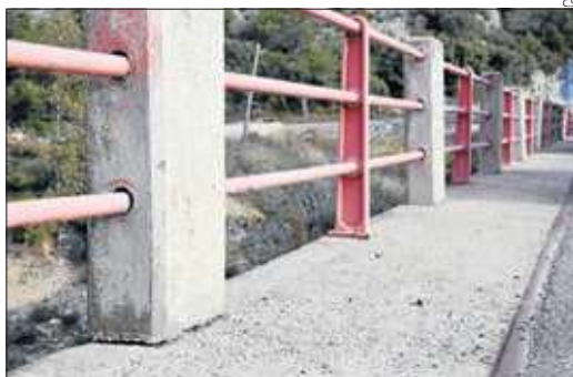
Alguns ancoratges de formigó del pont estan descalçats.
