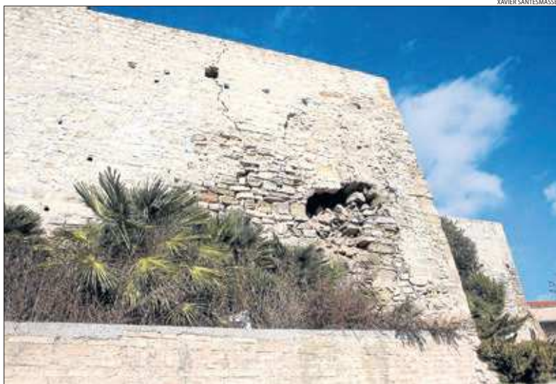
A la imatge, l'esvoranc a la muralla de Cervera, del segle XIV, i les esquerdes que ha provocat.
