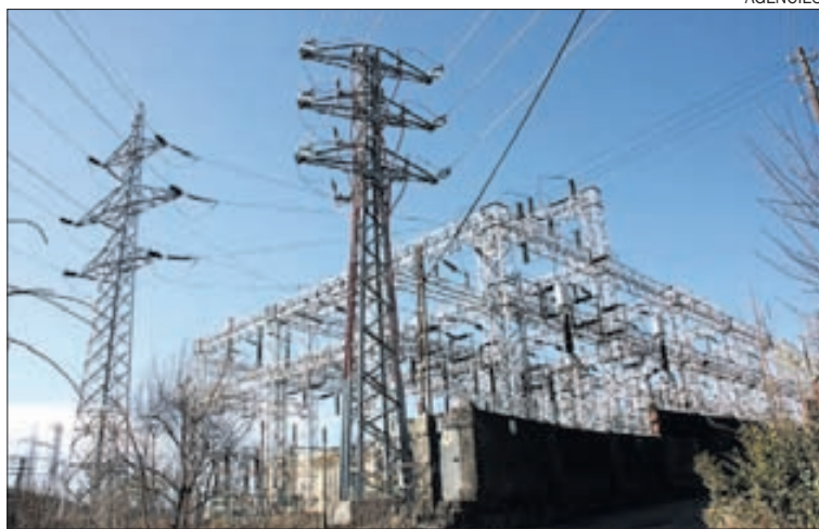
L'estació elèctrica de la Pobla de Segur.
