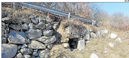
Despreniment al mur de contenci6 de la carretera entre Martinet i Lles
