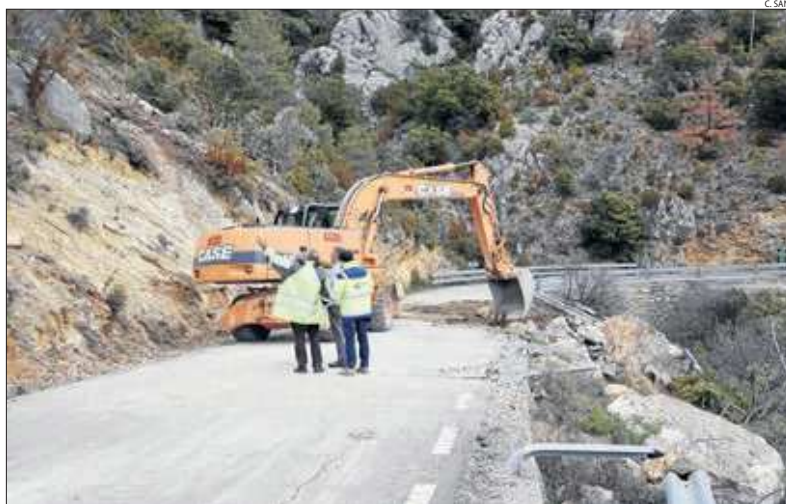
Els treballs ahir per reobrir la carretera de Montant de Tost després del despeniment de dimarts.
