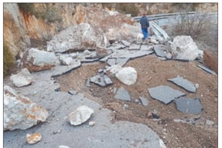
FOTO: Diputació de Lleida / Estat en el que va quedar la carretera
