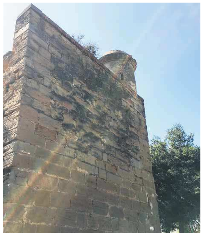
El mur degradat i la garita amb greus desperfectes que ara es recuperaran ■ J. TORT
