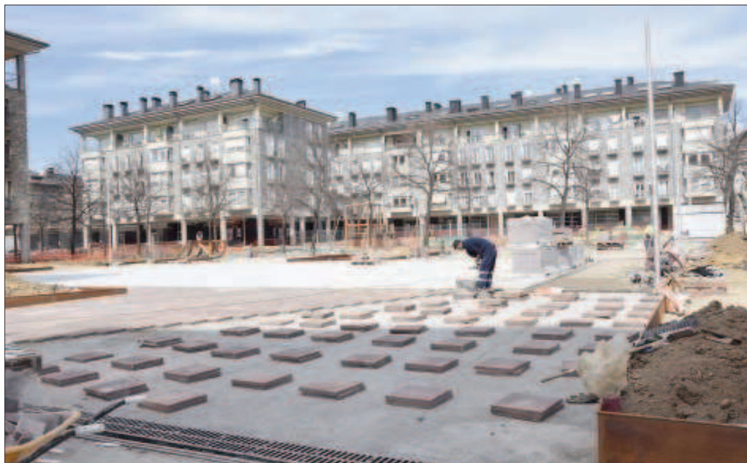
Un defecte ha obligat a repetir l'obra de la pista.
