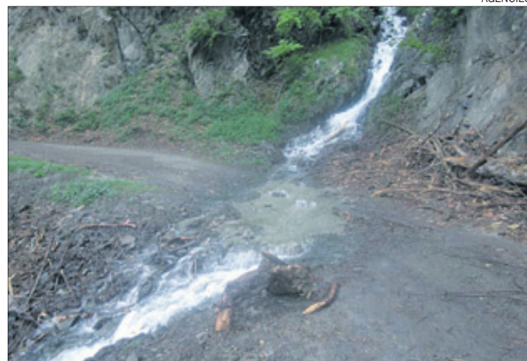
Un camí en mal estat a la Vall d'Aran.
