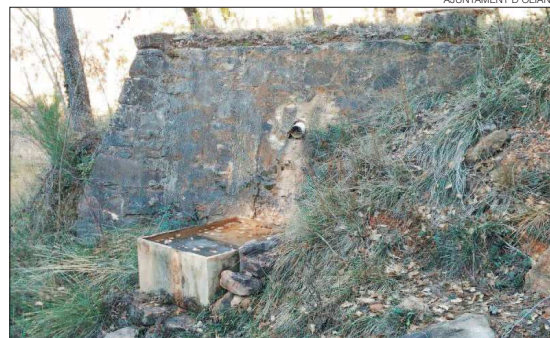
► Punt de captació d'aigua d'Oliana.
