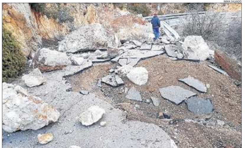
Les roques van destruir ahir el paviment de la carretera d'accés a Montant de Tost, a l'Alt Urgell.
