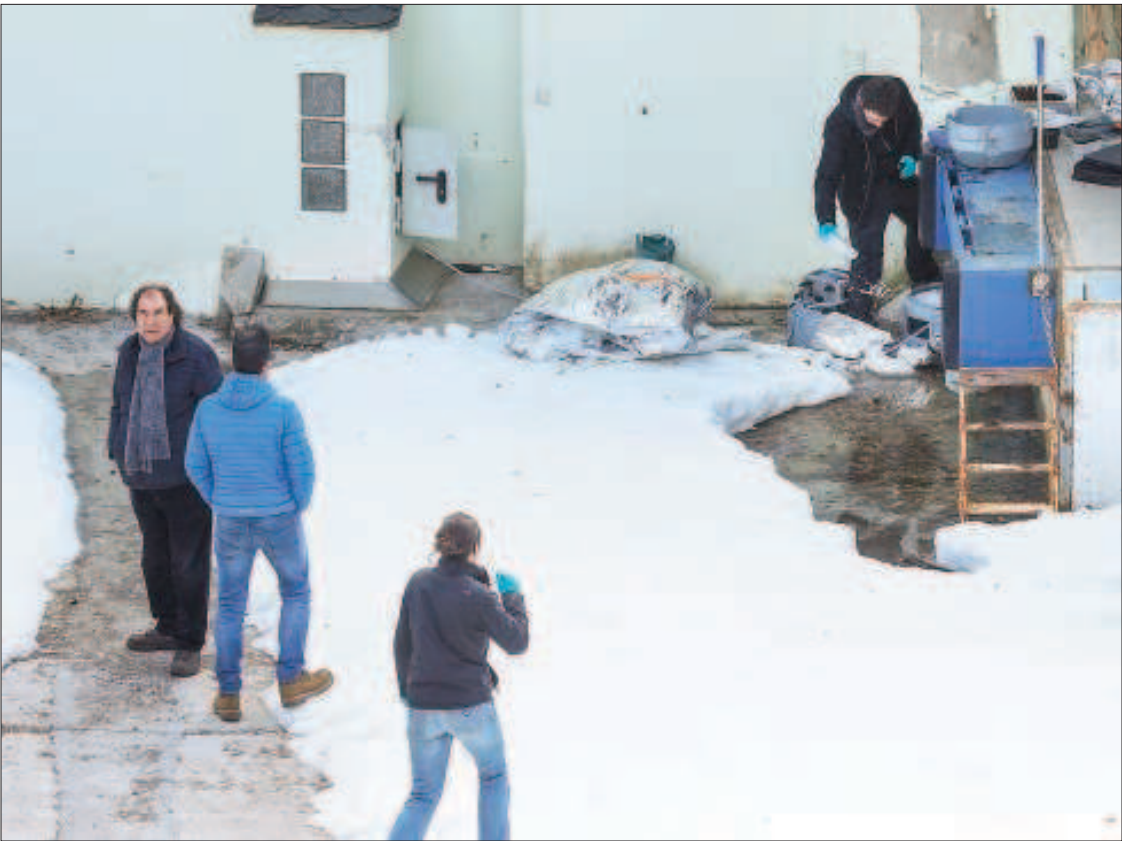
Els tècnics treballant a la planta d'Arinsal amb la presència del gerent d'Aigua del Pirineu. FERNANDO GALINDO
