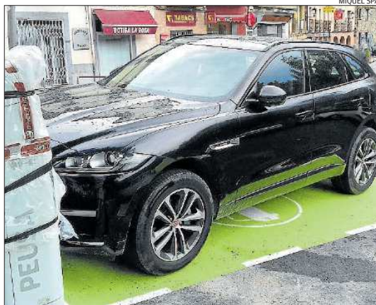
El punt de recàrrega elèctrica que PEUSA ha instal·lat a Martinet
