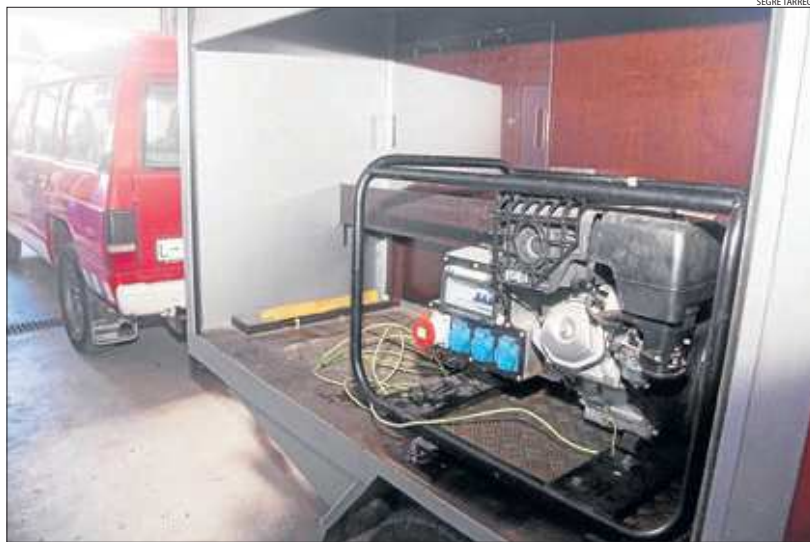
Els bombers de Torà han instal·lat aquest generador per poder tenir llum.
