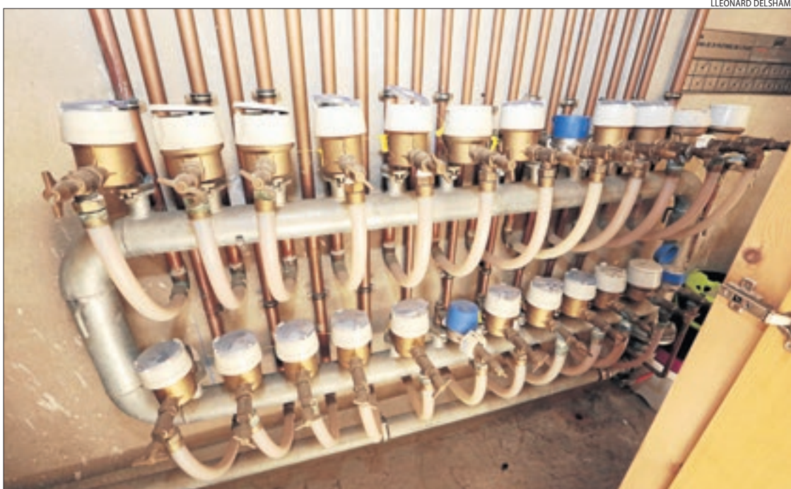
Comptadors d'aigua en un edifici d'habitatges.
