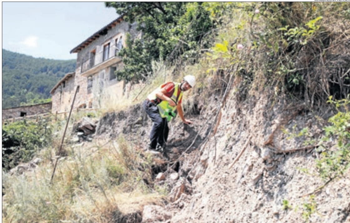
Imatge d'arxiu d'un geòleg analitzant el desprendiment d'un talús a Mencui.
