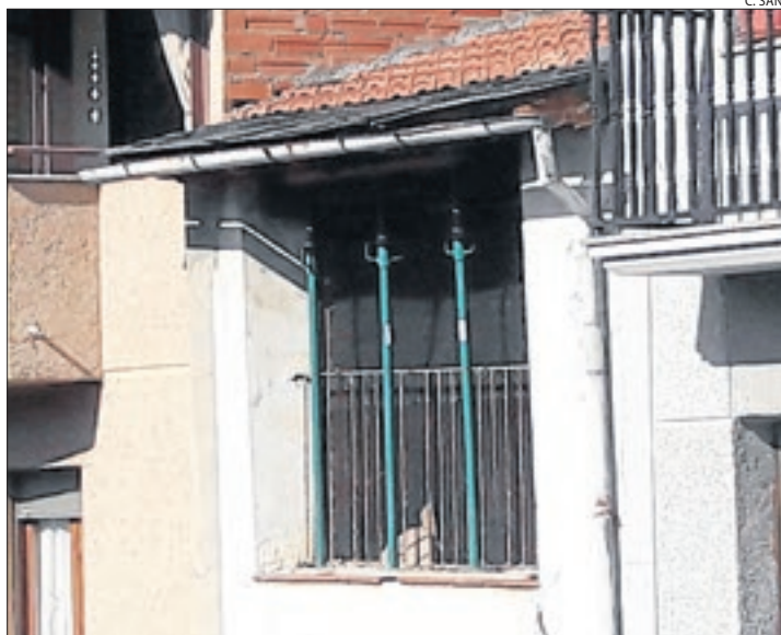
Teulada apuntalada en un edifici del centre de la Seu.
