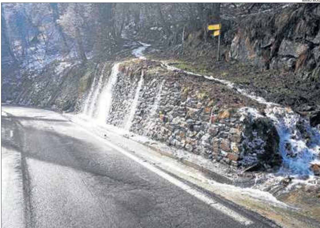
La carretera d'Eth Portilhon, sobre la qual cau el cabal de l'aigua procedent de neu i pluges.
