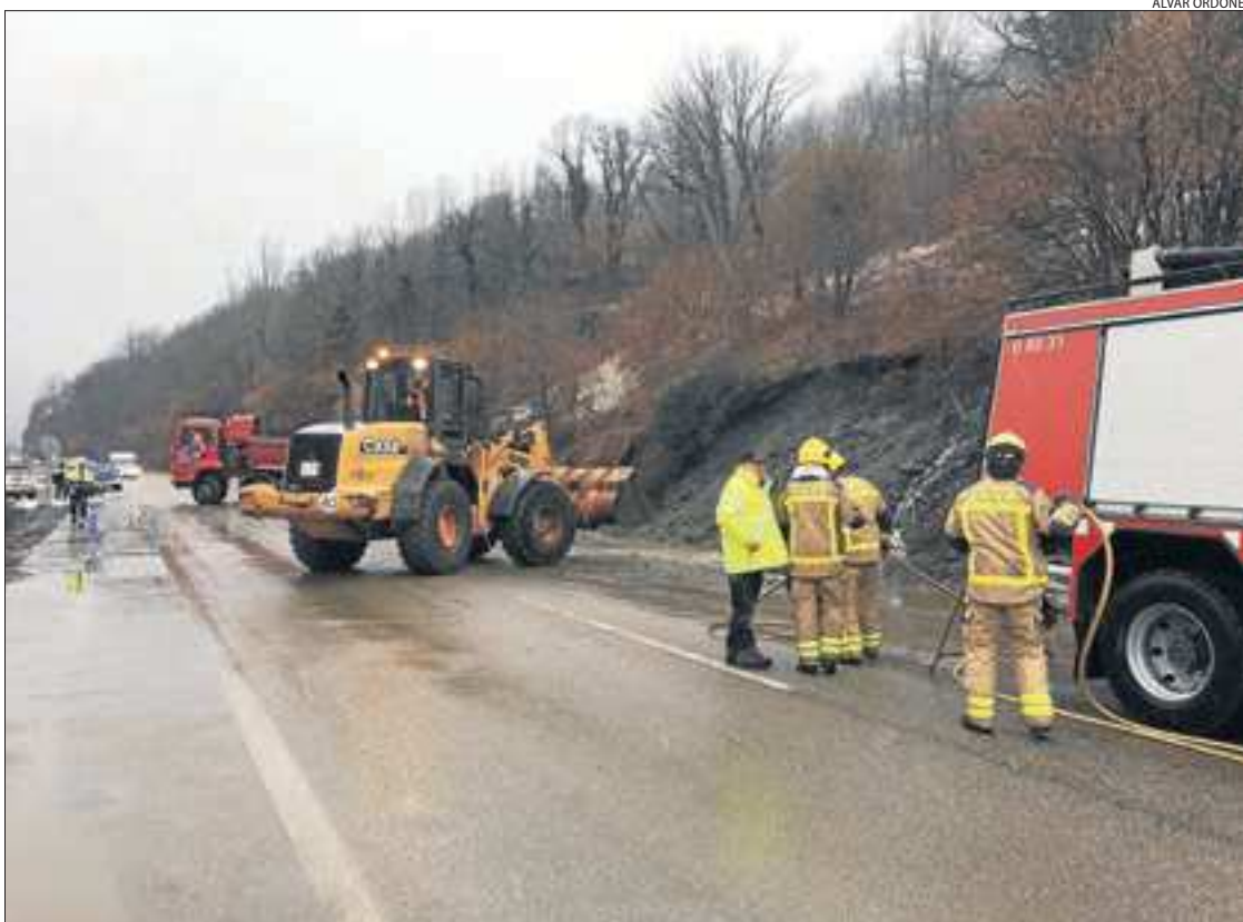
L'allau va ser retirada per bombers d'Aran i la concessionària del manteniment de la via.
