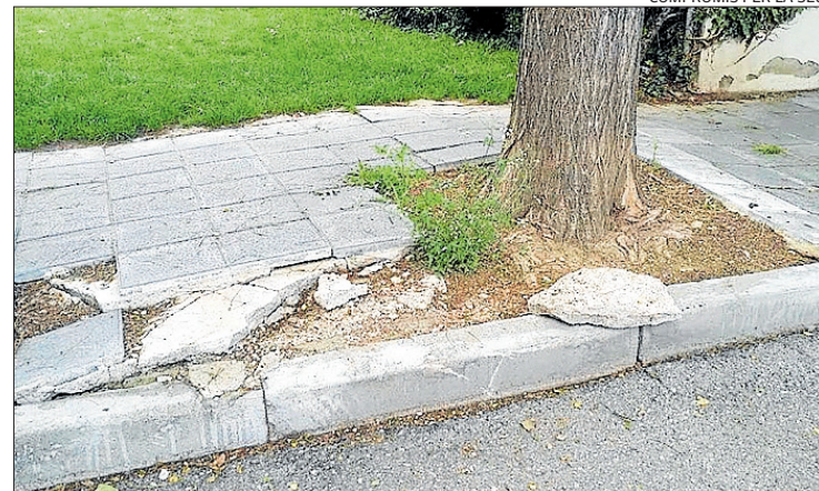
Exemple de carrer en mal estat que ha estat denunciat per Compromís
