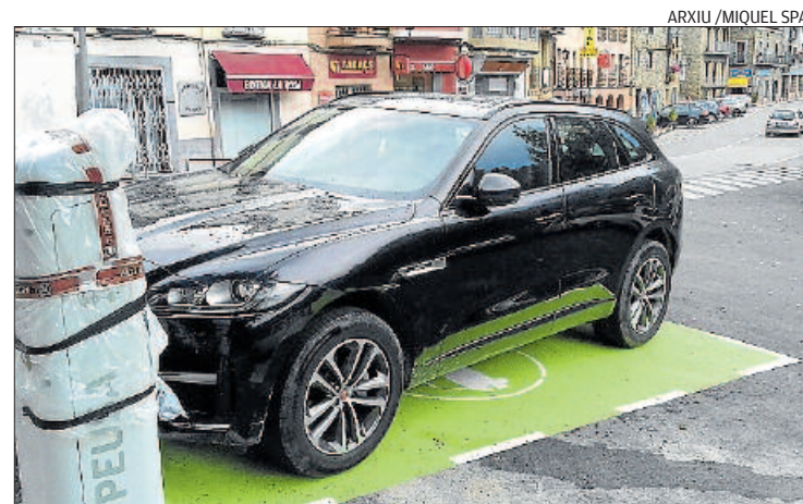
El carregador de vehicles elèctrics que Peusa ha instal·lat a Martinet
