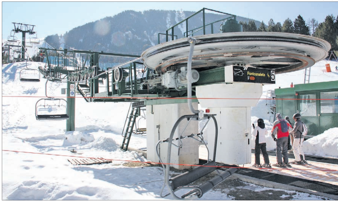
Pla general de l'entrada al remuntador de Fontcanaleta de l'estació d'esquí de La Molina.
