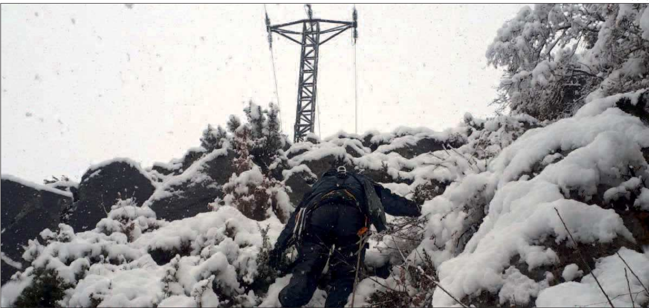
► Operari d'Endesa intentant accedir a una torre de subministrament elèctric a la Ribera d'Urgellet.
