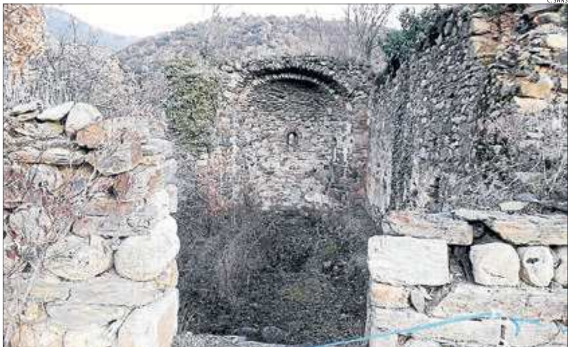
Imatge de les restes de Sant Esteve del Pont, a Castellciutat, que pateix un important deteriorament.
