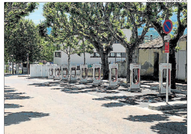
Els carregadors per a vehicles elèctrics instal·lats a la Seu
