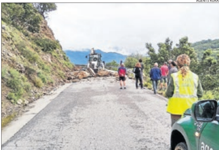
El desprendiment a la carretera de Castellbò.
