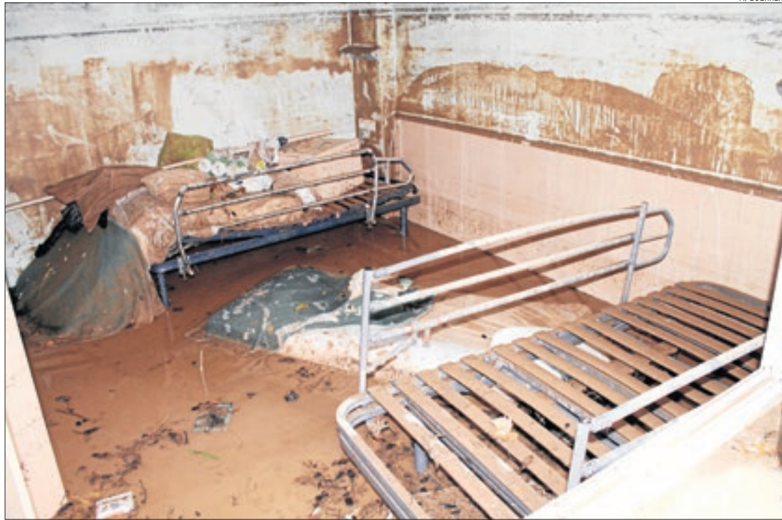
Estat en el qual va quedar una de les habitacions inundades de la residència.
